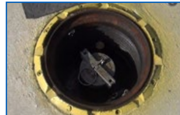
Fill Cap on Fill Pipe
